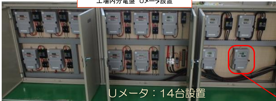
工場内分電盤 Uメータ設置
