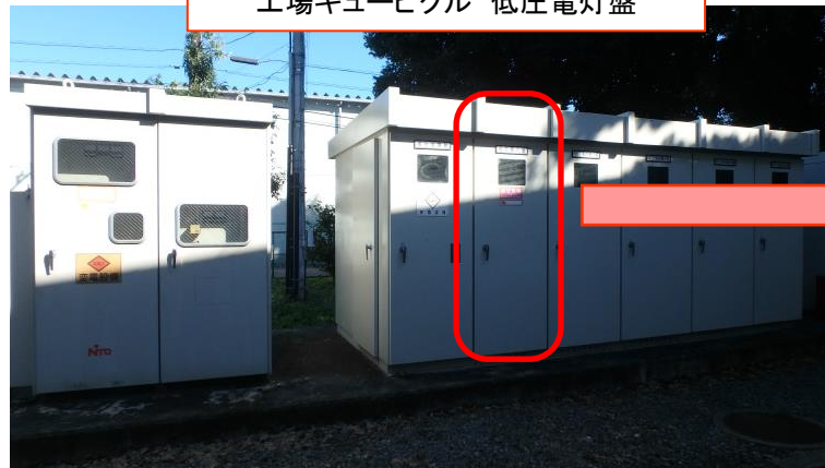
工場キュービクル 低圧電灯盤
